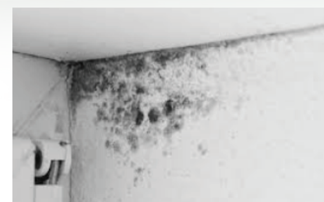
Tường nhà ẩm mốc
