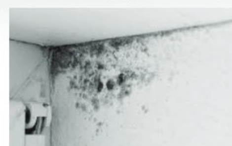
Tường nhà ẩm mốc
