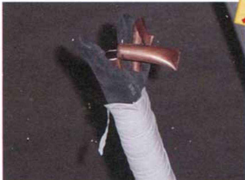
< Đầu ống không được bảo vệ (bọc kín) >
