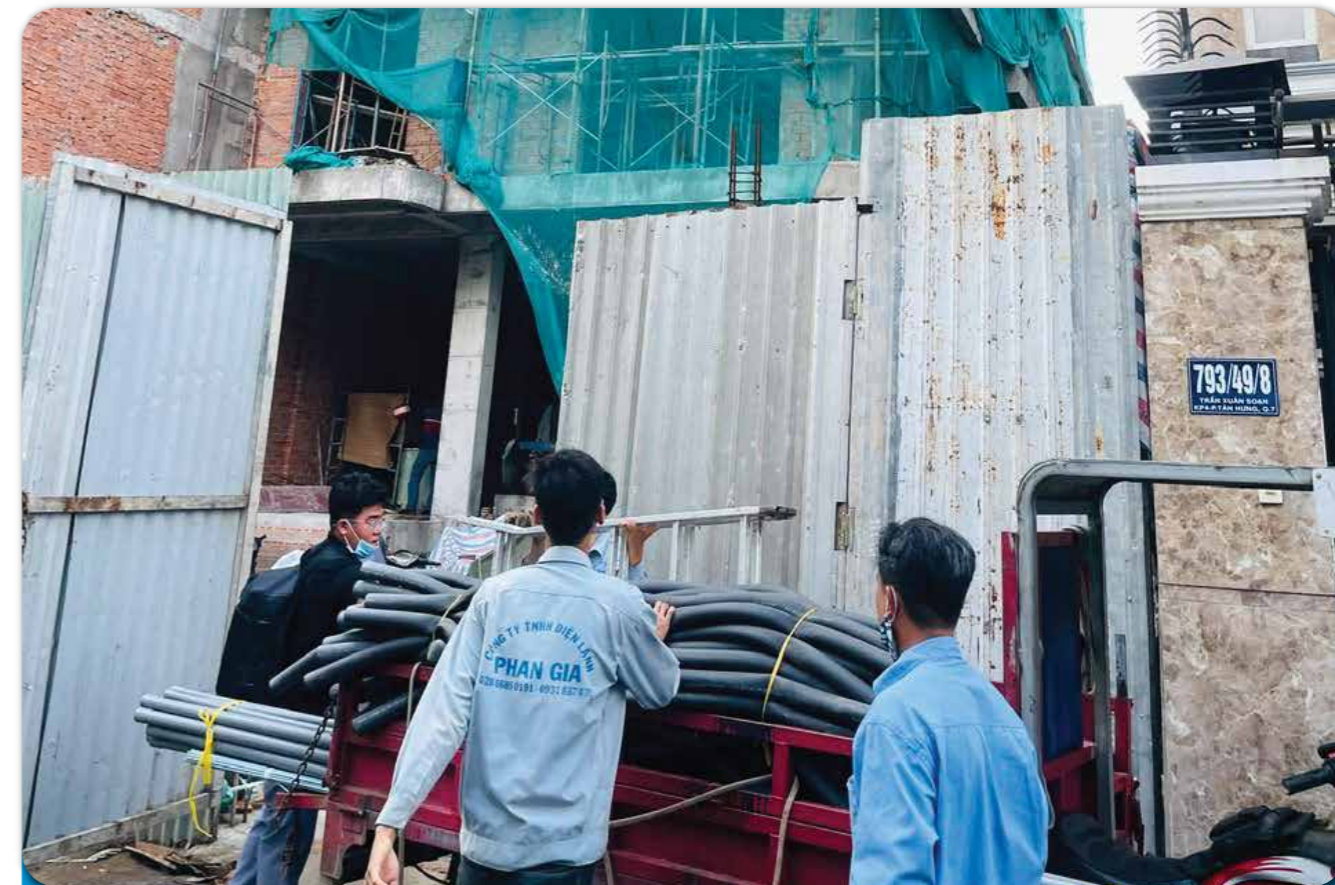
Dự án: THIẾT KẾ THI CÔNG MÁY LẠNH TRUNG TÂM VRV BIỆT THỰ CAO CẤP - QUẬN 7
