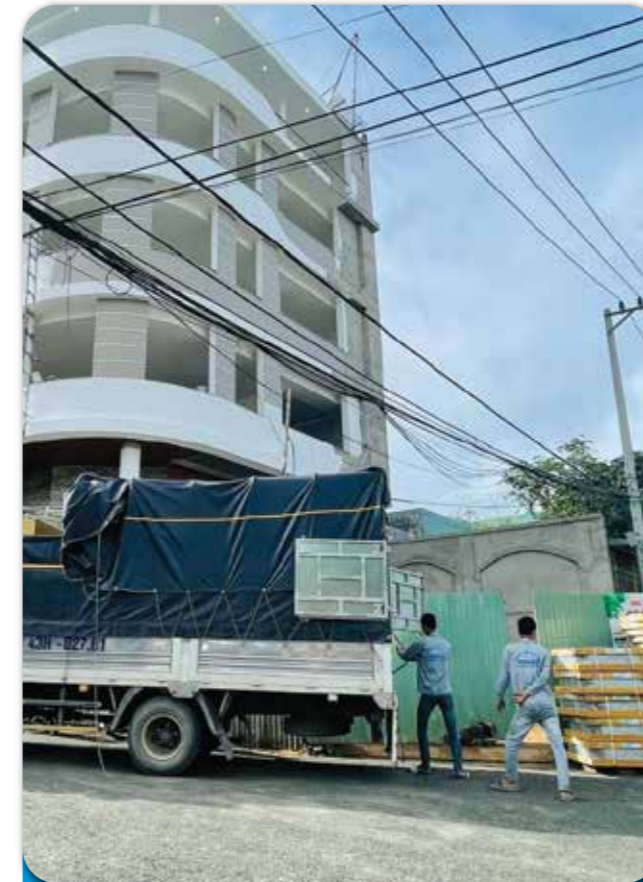
Dự án: THIẾT KẾ THI CÔNG MÁY LẠNH TRUNG TÂM VRV TÒA NHÀ VĂN PHÒNG - GIA LAI
