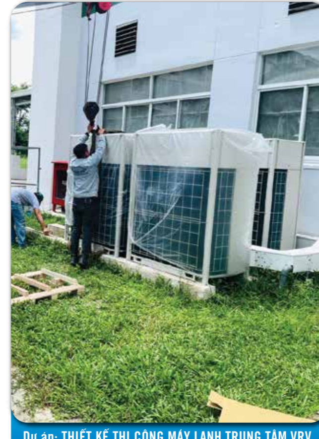
Dự án: THIẾT KẾ THI CÔNG MÁY LẠNH TRUNG TÂM VRV 56HP CHO VĂN PHÒNG NHÀ MÁY TẠI KHU CÔNG NGHIỆP LONG HẬU - LONG AN
