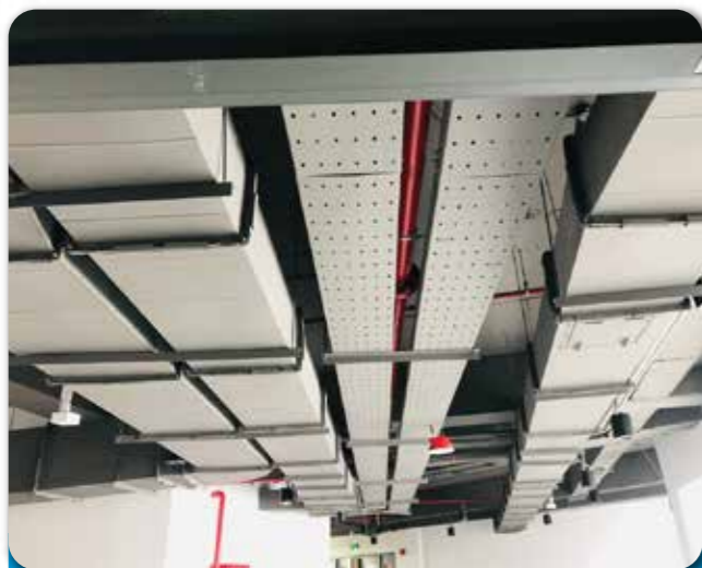
Dự án: THIẾT KẾ, THI CÔNG HỆ THỐNG THÔNG GIÓ CHO TRƯỜNG QUỐC TẾ AIS, QUẬN 2
