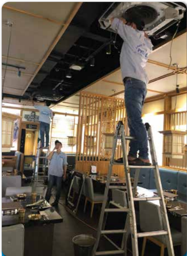
Dự án: BẢO TRÌ MÁY LẠNH TRUNG TÂM CHO NHÀ HÀNG
