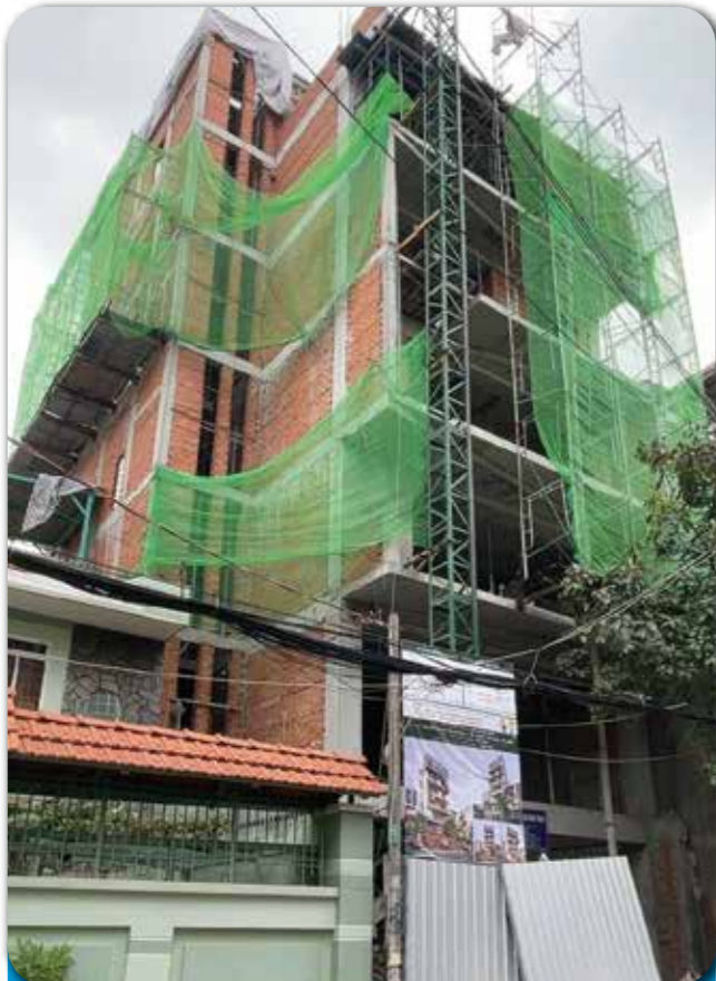
Dự án: THIẾT KẾ THI CÔNG MÁY LẠNH TRUNG TÂM VRV BIỆT THỰ CAO CẤP - QUẬN TÂN BÌNH
