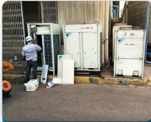
Dự án: BẢO TRÌ MÁY LẠNH TRUNG TÂM CHO NHÀ MÁY TÔN HOA SEN
