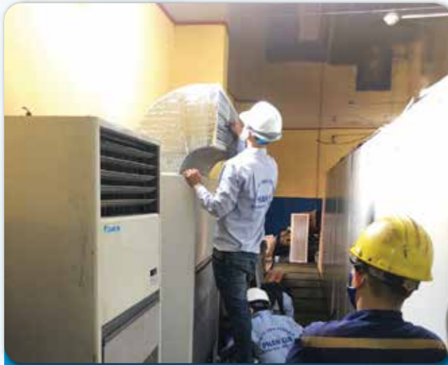
Dự án: CUNG CẤP, LẮP ĐẶT MÁY LẠNH PACKAGED NỐI ỚNG GIÓ CHO NHÀ MÁY TÔN HOA SEN BÀ RỊA - VÙNG TÂY
