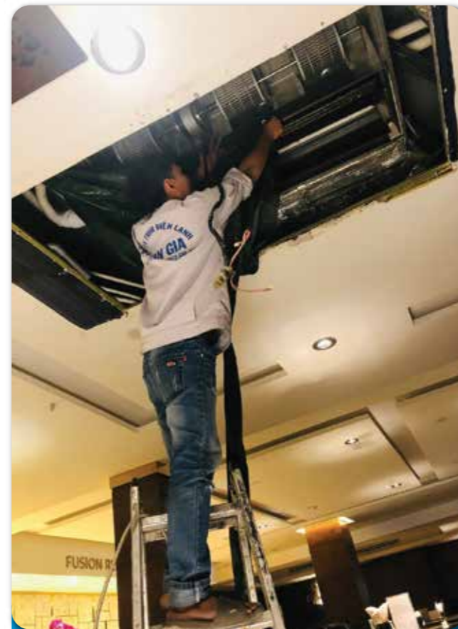
Dự án: BẢO TRÌ MÁY LẠNH GIẤU TRẦN NỐI ỐNG GIÓ CHO SÂN NHÀ HÀNG
