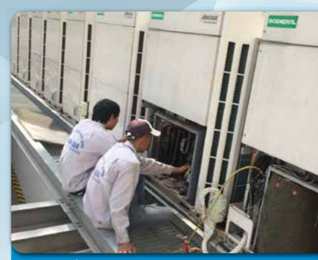
Dự án: KIỂM TRA XỬ LÝ LỖI MÁY LẠNH TRUNG TÂM CHO TÒA NHÀ KUSTO (ĐẢO KIM CƯƠNG)
