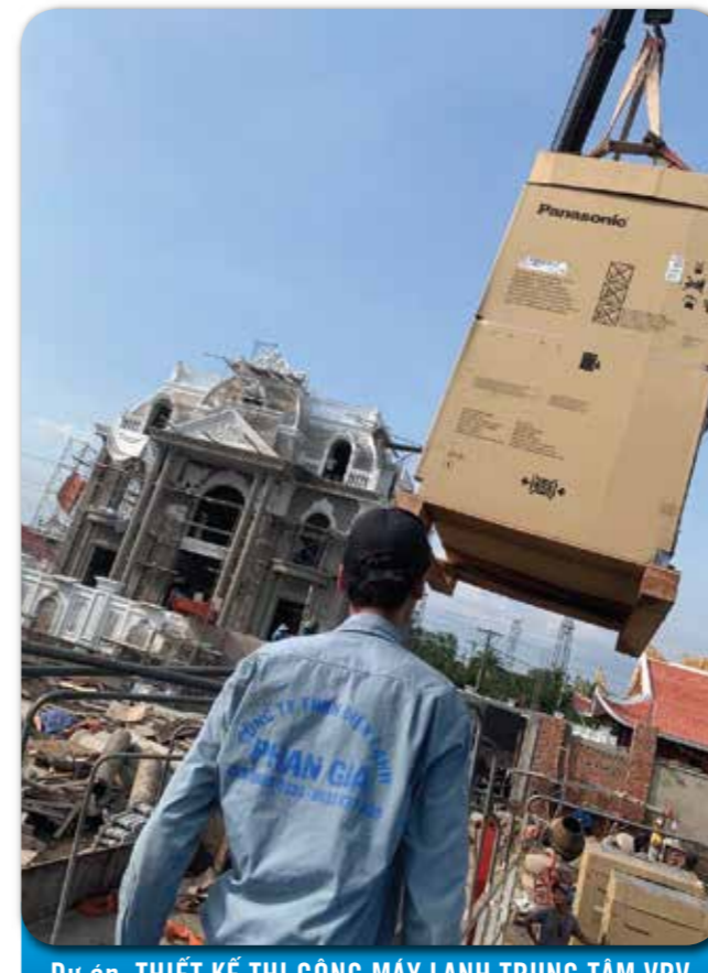
Dự án: THIẾT KẾ THI CÔNG MÁY LẠNH TRUNG TÂM VRV BIỆT THỰ CAO CẤP - TRẠM DỪNG CHÂN MINH PHÁT 2 - CAI LẬY TIỀN GIANG
