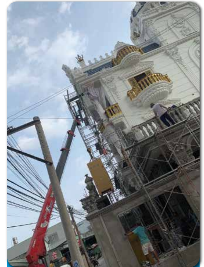
Dự án: THIẾT KẾ THI CÔNG MÁY LẠNH TRUNG TÂM VRV CHO LẦU ĐÀI - ĐỨC HÒA LONG AN
