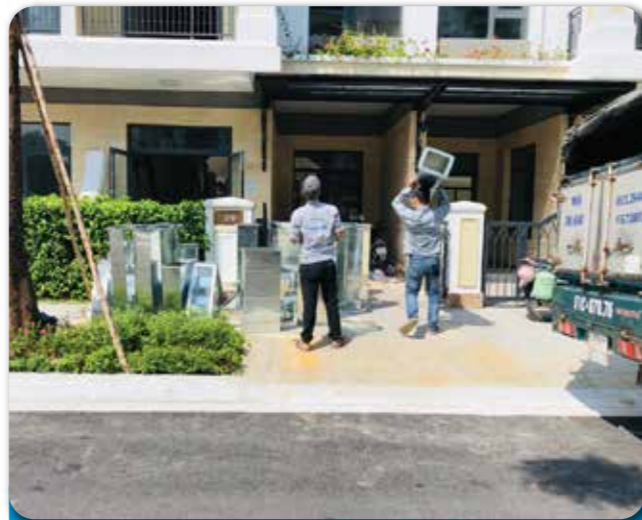
Dự án: CUNG CẤP, LẮP ĐẶT MÁY LẠNH TRUNG TÂM VRV A CHO BIỆT THỰ LIÊN KỀ KHANG ĐIỀN VEROSA, QUẬN 9
