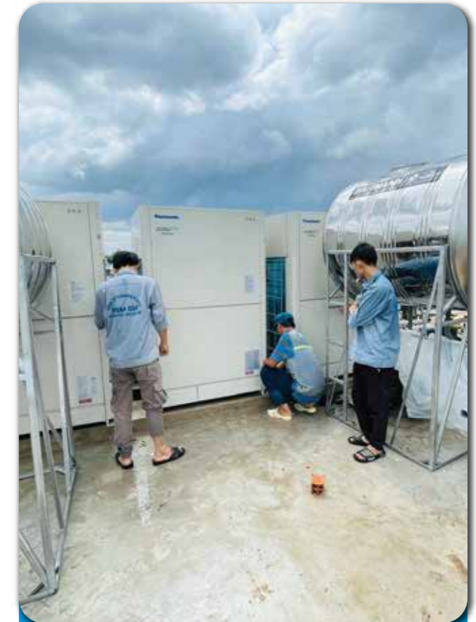
Dự án: THIẾT KẾ THI CÔNG MÁY LẠNH TRUNG TÂM VRV TRUNG TÂM ANH NGŨ - Q10
