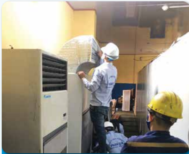
Dự án: CUNG CẤP, LẮP ĐẶT MÁY LẠNH PACKAGED NỐI ỚNG GIÓ CHO NHÀ MÁY TÒN HOA SEN BÀ RỊA - VÙNG TÂY
