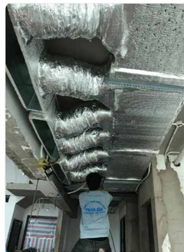
Dự án: CUNG CẤP, THI CÔNG MÁY LẠNH GIẤU TRẦN NỐI ỚNG GIÓ
