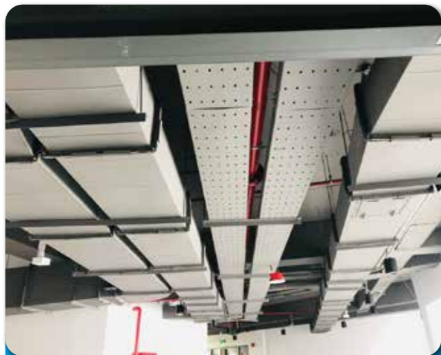
Dự án: THIẾT KẾ, THI CÔNG HỆ THỐNG THÔNG GIÓ CHO TRƯỜNG QUỐC TẾ AIS, QUẬN 2
