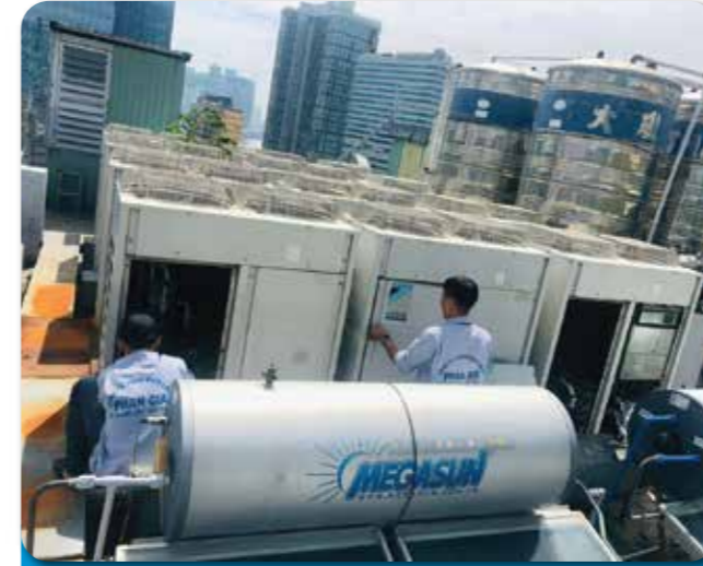
Dự án: BẢO TRÌ MÁY LẠNH TRUNG TÂM CHO KHÁCH SẠN TẠI QUẬN 1
