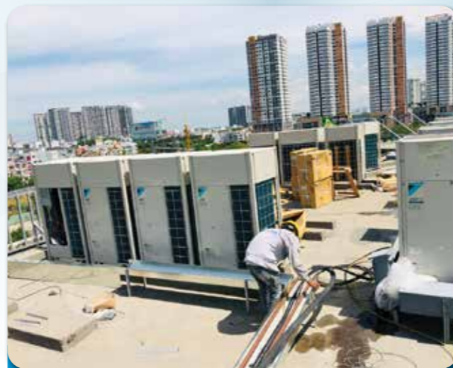
Dự án: THIẾT KẾ, THI CÔNG MÁY LẠNH TRUNG TÂM VRV A CHO SHOWROOM
