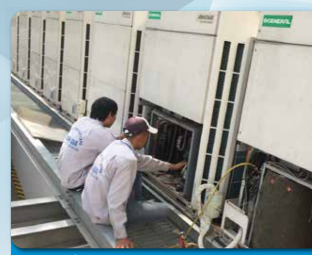
Dự án: KIỂM TRA XỬ LÝ LỖI MÁY LẠNH TRUNG TÂM CHO TÒA NHÀ KUSTO (ĐẢO KIM CƯƠNG)
