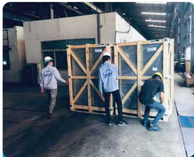
Dự án: CUNG CẤP, LẮP ĐẶT MÁY LẠNH PACKAGED CHO NHÀ MÁY TÔN HOA SEN BÀ RỊA - VÙNG TÀU
