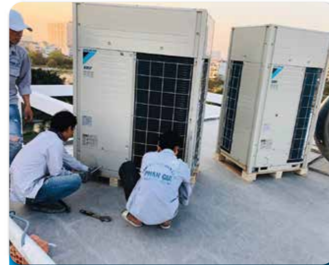
Dự án: THIẾT KẾ THI CÔNG MÁY LẠNH TRUNG TÂM VRV A CHO BIỆT THỰ TRIỆU ĐO CỬA NGỌC TRINH TẠI QUẬN 9
