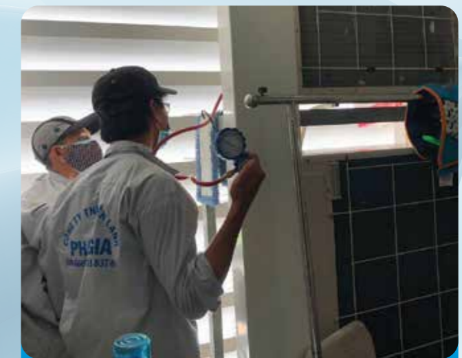
Dự án: BẢO TRÌ, SỬA CHỮA MÁY LẠNH TRUNG TÂM CHO KHÁCH HÀNG TẠI ĐẢO KIM CƯƠNG, QUẬN 2
