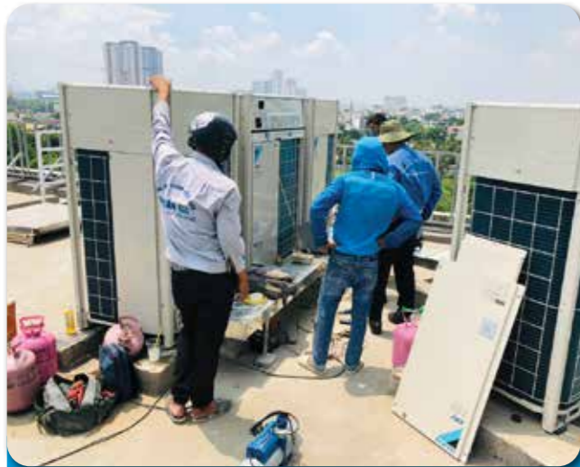
Dự án: CUNG CẤP, LẮP ĐẶT MÁY LẠNH TRUNG TÂM VRV A CHO CHUỖI CAFE & TEA PHÚC LONG
