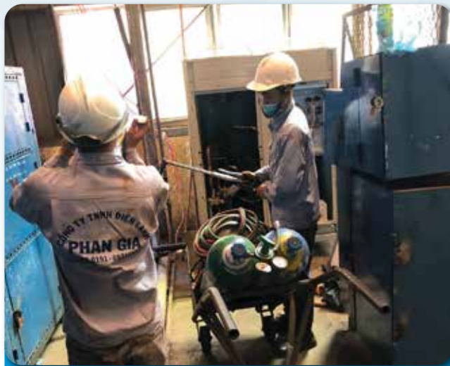
Dự án: THI CÔNG MÁY LẠNH TRUNG TÂM CHO NHÀ MÁY SATEX
