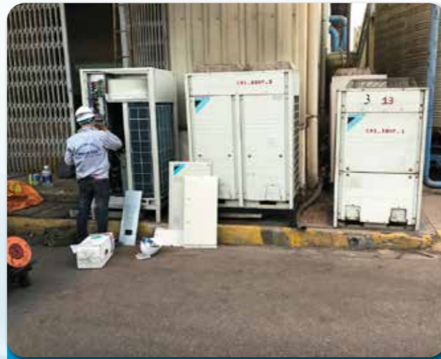
Dự án: BẢO TRÌ MÁY LẠNH TRUNG TÂM CHO NHÀ MÁY TÒN HOA SEN
